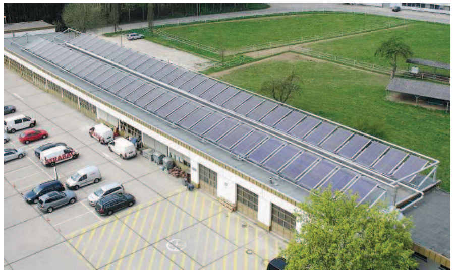
Abb. 3.1-1: Kollektorfeld der solaren Klimatisierungsanlage Rottweil
