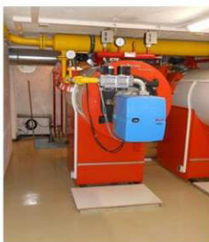
Heizkessel 285 kW th.
