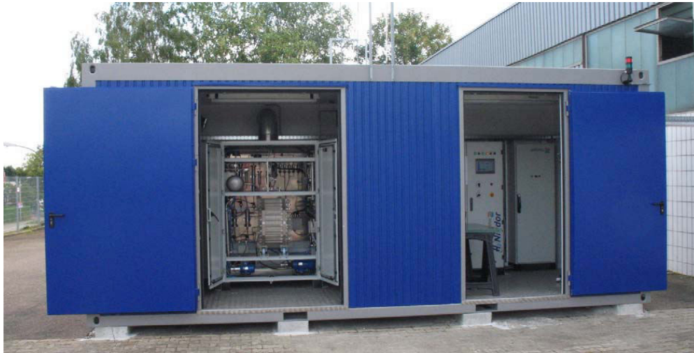
Abbildung 2-49: Wasserstoff-Systemeinheit im Normcontainer mit Blick auf den Elektrolyseur (links) und Steuerschranke (rechts).
