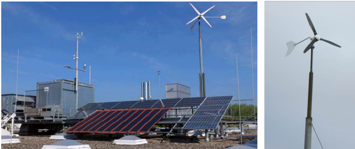
Abbildung 2-6: Die Außenanlagen der Energieinsel als Teil des Testfelds für erneuerbare Energietechnik und Wettermeßtechnik am Hauptcampus der Hochschule Offenburg. Rechts: Windgenerator seit 2015
