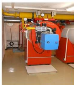
Heizkessel 285 kW th.
